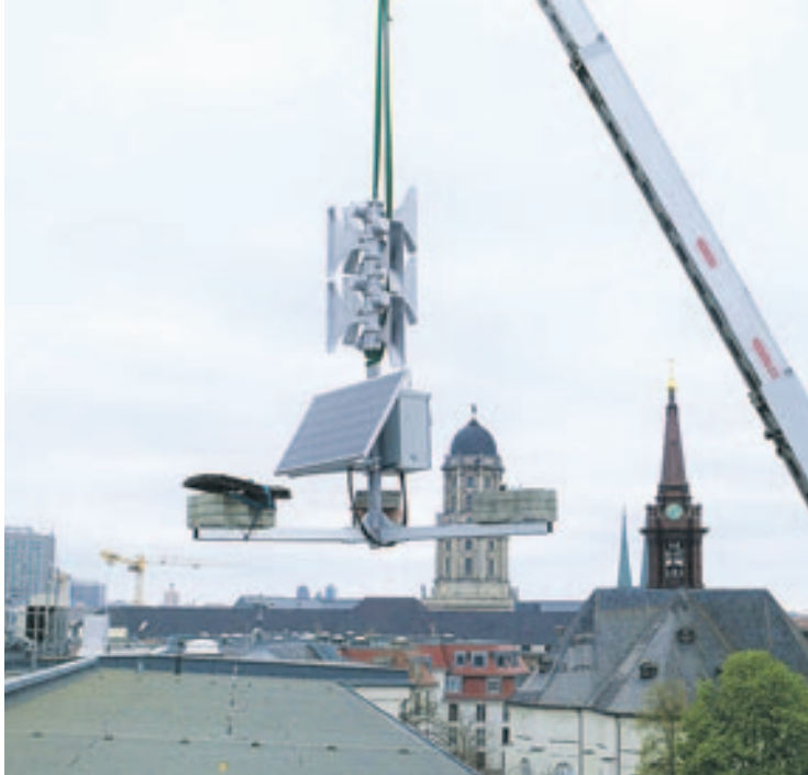
Nachdem es jahrzehntlang in Berlin keine Sirenen mehr gab, soll sich das nun ändern. Bis 2023 werden 400 Warngeräte in der ganzen Stadt installiert. Eine der ersten Sirenen wurde Ende April auf dem Dach der Feuerwache Mitte aufgebaut. Foto: Feuerwehr Berlin
