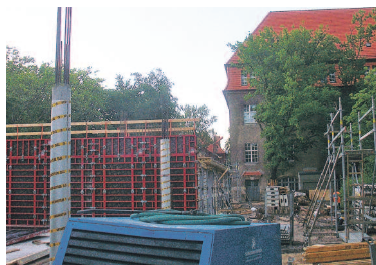
Gebaut und renoviert wurde bislang viel zu wenig: Der Sanierungsstau an Berliner Schulen ist auf mehr als sieben Milliarden Euro angewachsen.
