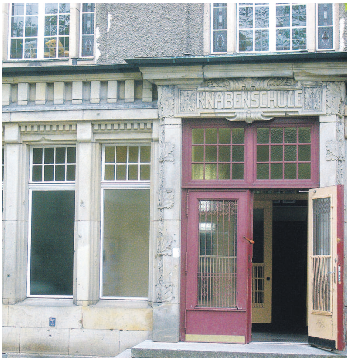
Denkmalgeschützt und renovierungsbedürftig: Viele der Schulbauten im Bezirk (wie hier die Süd-Grundschule) sind mehr als 100 Jahre alt und dementsprechend sanierungsbedürftig. Fotos: M. A. Schmidt
